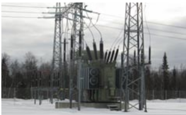
Основная энерго-электростанция 45/110/220 kV в Вявуниеми, Ивало .
